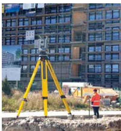
Für die im Bereich der Ingenieurvermessungen oft verlangte hohe Messgenauigkeit wurde 2019 für den Fachdienst Vermessung eine Robotic-Totalstation beschafft. Dieses Instrument kennzeichnet u.a. aus, dass es mittels Funk gesteuert wird. Es sucht selbständig nach dem dazugehörigen Reflektor beim Bearbeiter. Die Messungen werden über ein feldtaugliches Tablet aus der Ferne ausgelöst.
