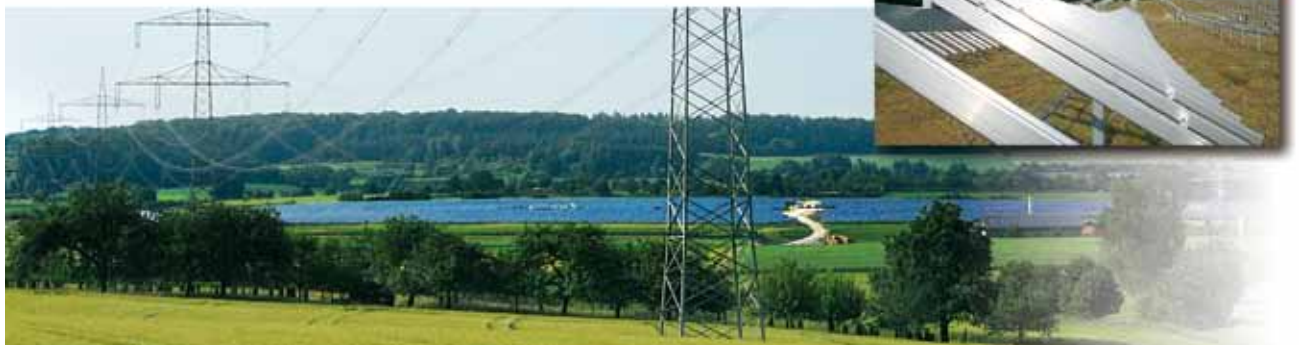
Photovoltaikanlage Ulm/Eggingen und Unterkonstruktion der Anlage in Erbach (kleines Bild oben)
