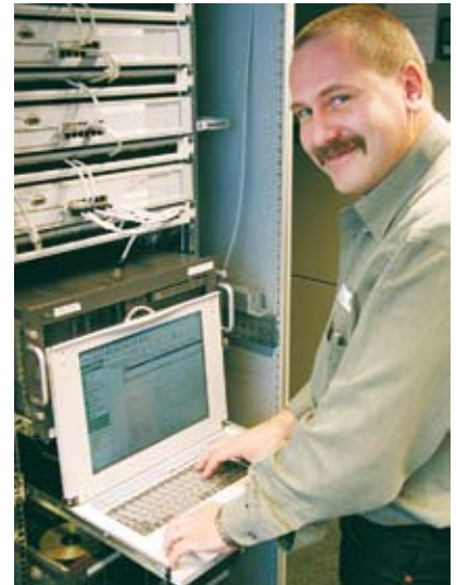
Datennetzverteiler im Landratsamt
