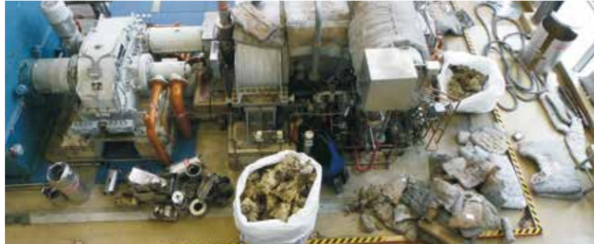
Die Turbine im Müllheizkraftwerk Ulm-Donautal wird auf Herz und Nieren geprüft.
