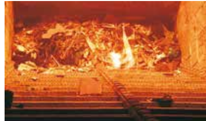
Blick in den Verbrennungstrakt beim Müllheizkraftwerk Ulm-Donautal.
