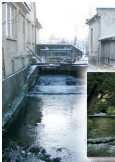
Stauanlage: eine Durchgängigkeit ist nicht gegeben
